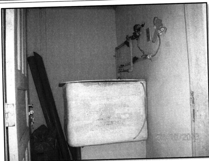
FIGURA 2.197 – INSTALAÇÕES DA CASA DE TRATAMENTO NA COMUNIDADE RIO XV. FONTE: TRABALHO DE CAMPO AMBIENTAL COSTA OESTE (2014).
