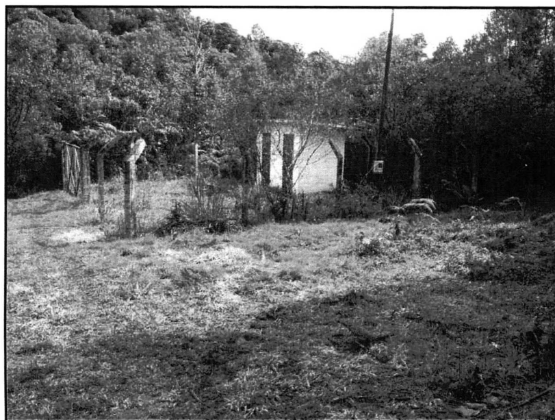
FIGURA 2.180 – SITUAÇÃO PRECÁRIA DAS INSTALAÇÕES DO POÇO NA VILA RURAL RIO DO MEIO.
