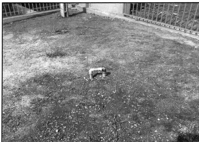
FIGURA 2.184 – SITUAÇÃO PRECÁRIA DAS INSTALAÇÕES DO POÇO NA ESCOLA DA COMUNIDADE RIO DO MEIO.
