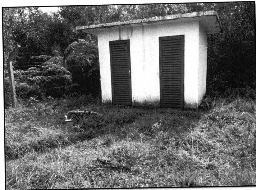
FIGURA 2.182 – SITUAÇÃO PRECÁRIA DAS INSTALAÇÕES DO POÇO NA VILA RURAL RIO DO MEIO.
