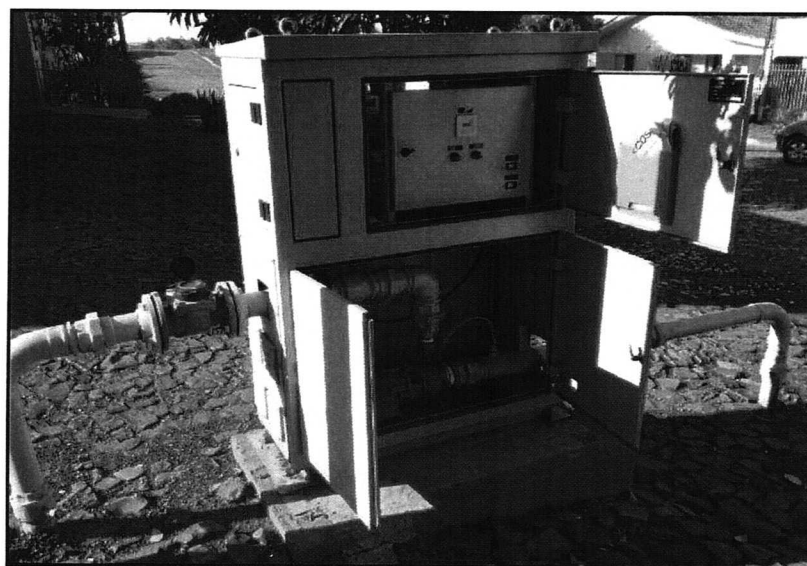
FIGURA 2.142 – BOOSTER NO BAIRRO PLANALTO.
