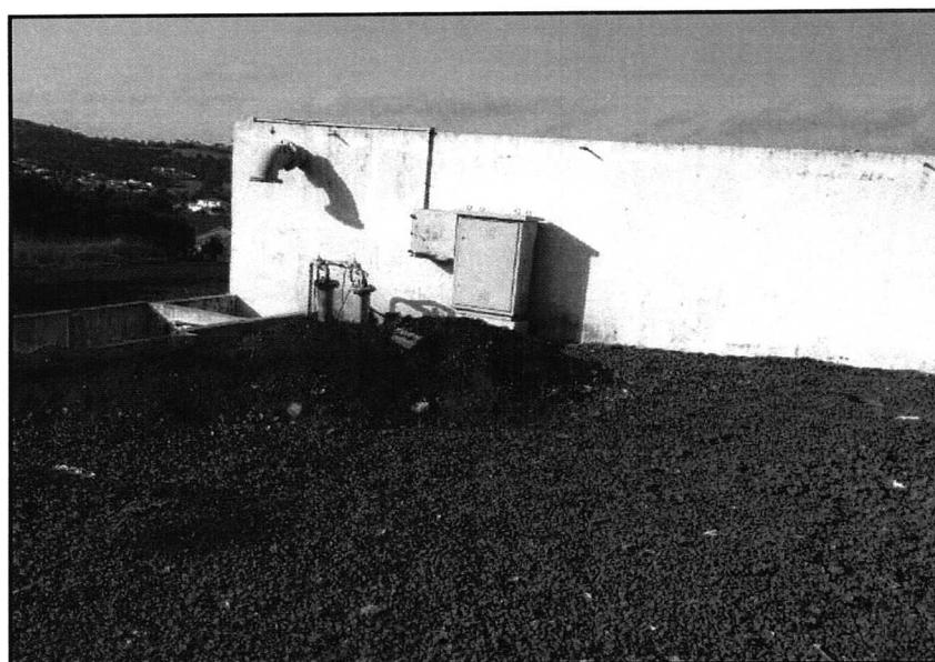
FIGURA 2.127 – BOMBAS SUBMERSAS E QUADRO DE ENERGIA DO RESERVATÓRIO PITANGUINHA. FONTE: TRABALHO DE CAMPO, AMBIENTAL COSTA OESTE (2014).
