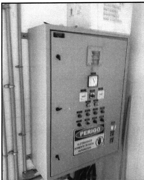
FIGURA 2.135 – QUADRO DE ENERGIA NO LOCAL DO RESERVATÓRIO DO PLANALTO. FONTE: TRABALHO DE CAMPO, AMBIENTAL COSTA OESTE (2014).
