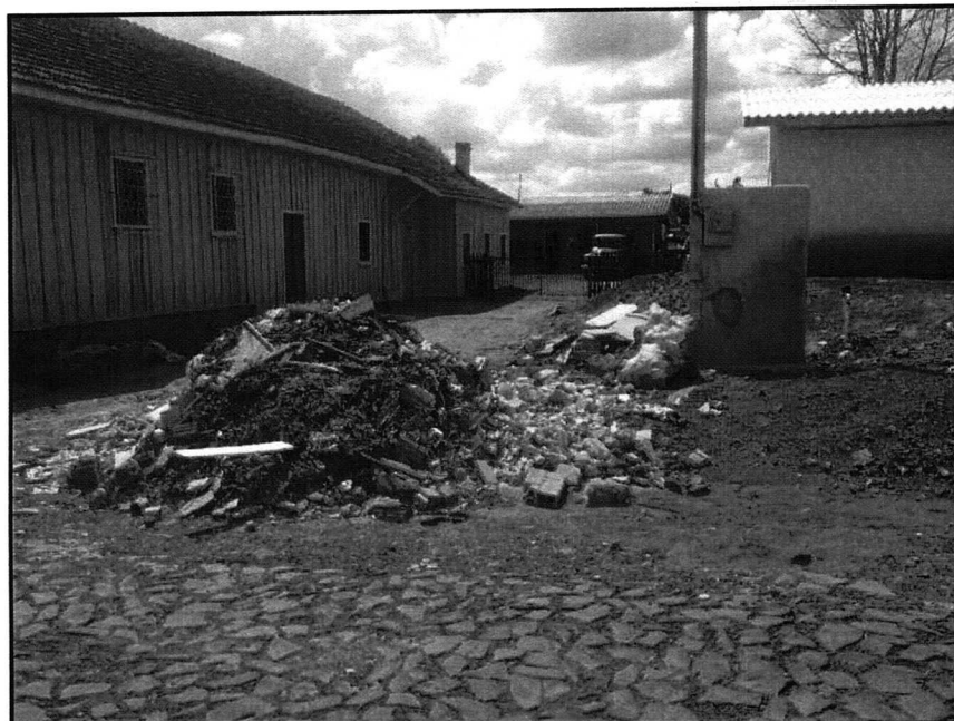
FIGURA 2.82 – ACONDICIONAMENTO DOS RCC DE FORMA ERRADA PELOS MUNICÍPIES. FONTE – TRABALHO DE CAMPO EMPRESA AMBIENTAL COSTA OESTE (2014).
