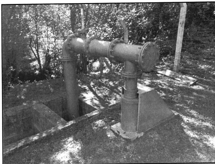
FIGURA 2.117 – POÇO DE CAPTAÇÃO. FONTE: TRABALHO DE CAMPO, AMBIENTAL COSTA OESTE (2014).
