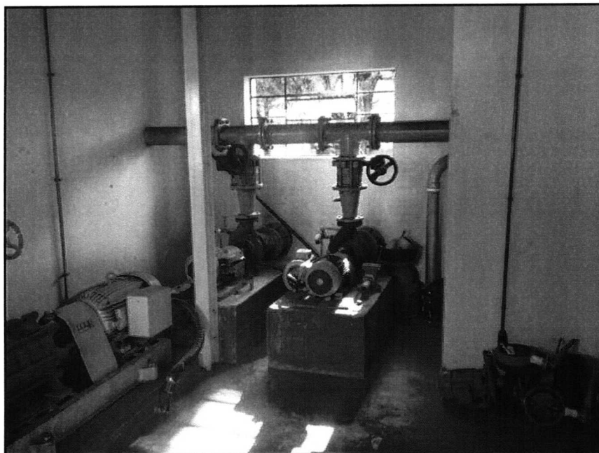
FIGURA 2.112 – ESTAÇÃO ELEVATÓRIA DE ÁGUA BRUTA. FONTE: TRABALHO DE CAMPO, AMBIENTAL COSTA OESTE (2014).
