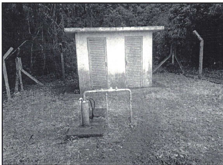
FIGURA 2.196 - INSTALAÇÕES DO POÇO NA VILA RURAL DA COMUNIDADE RIO XV. FONTE: TRABALHO DE CAMPO AMBIENTAL COSTA OESTE (2014).
